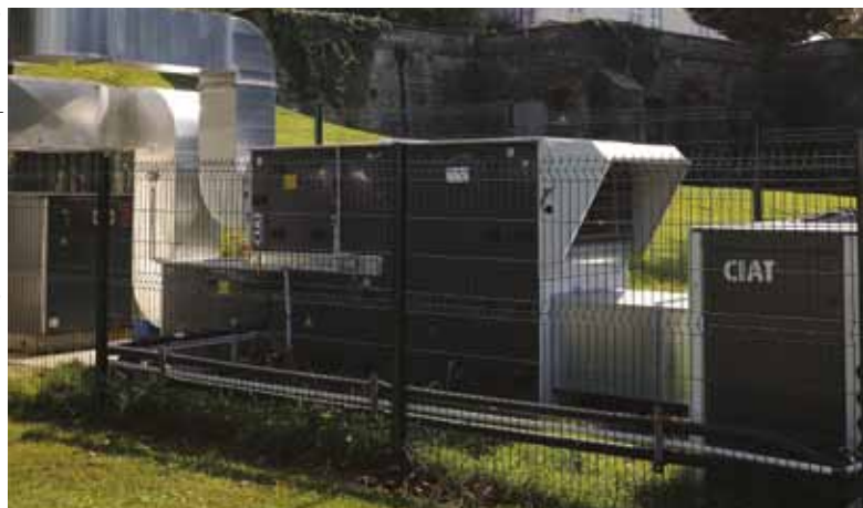
La centrale de traitement d'air
