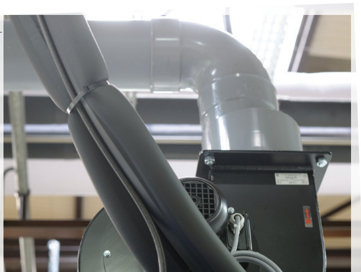
Photo 13 • Sortie d'air raccordée sur l'extérieur
