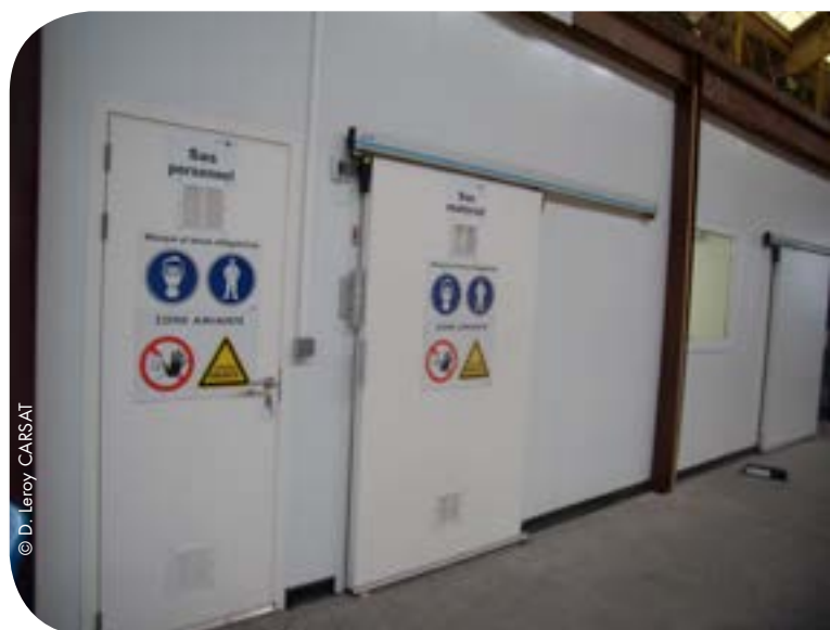
Salle « blanche » pour l'entretien des équipements contaminés
