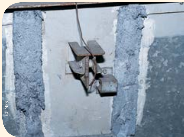
Sonde enrobée d'un mastic souple amianté
