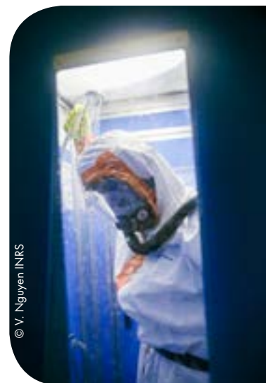
Douche de décontamination
