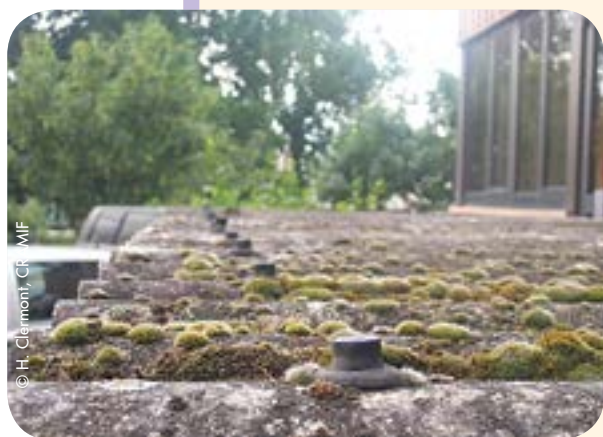
Toiture recouverte de mousses
