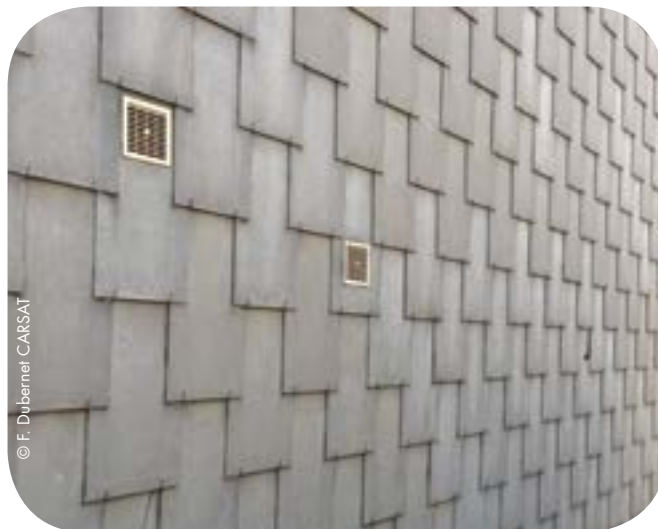
Bardage décoratif en amiante-ciment
