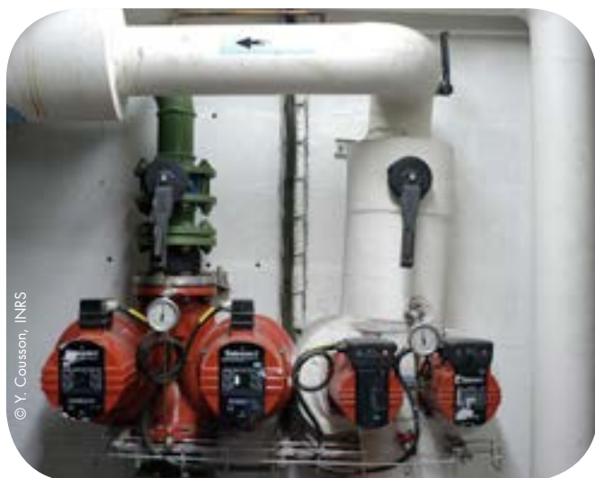
Calorifugeage de conduits
