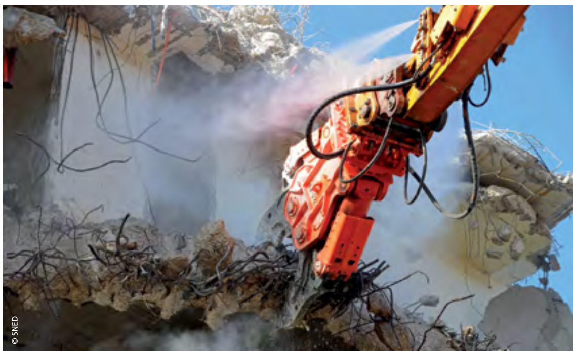
Brumisation embarquée sur le bras d'un engin
