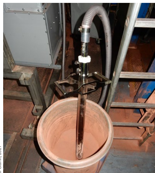
■ Canne d'aspiration placée dans une cuve de matériaux pulvérulents
