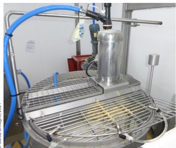
■ Cuve de mélange, vue de dessus (depuis la plateforme)
