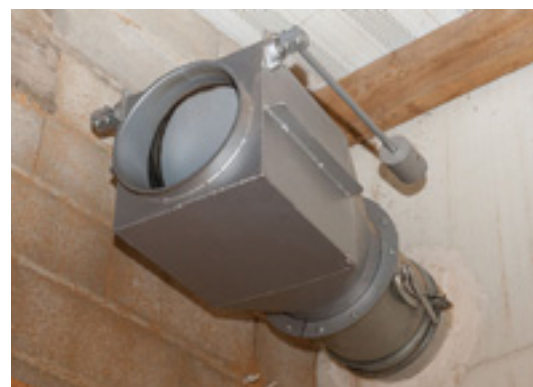
Entrée d'air additionnelle.
