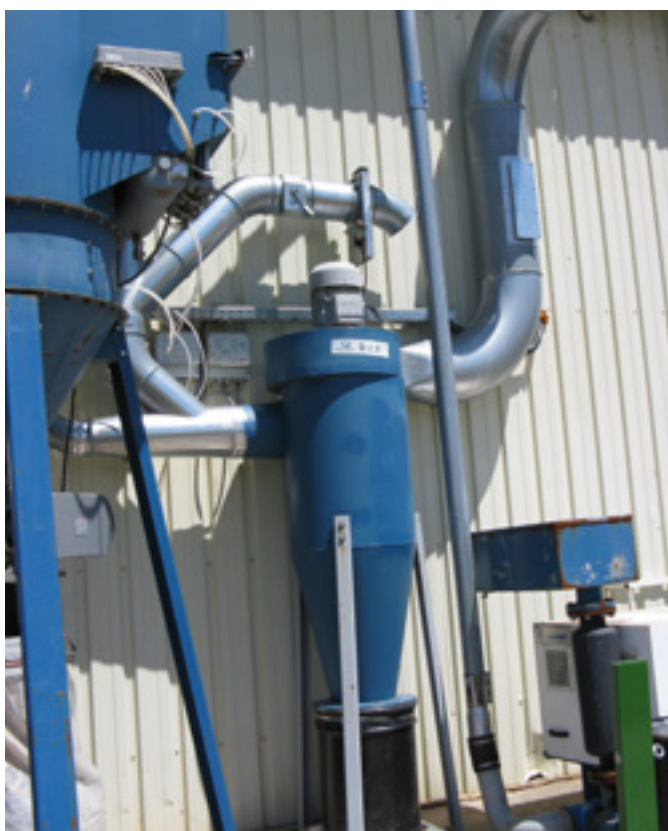
Cyclone de séparation air/matière avec trappe normalisée.
