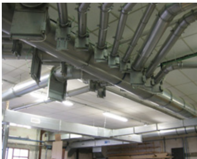
Piquage des conduites vers les différentes machines sur le collecteur principal.
