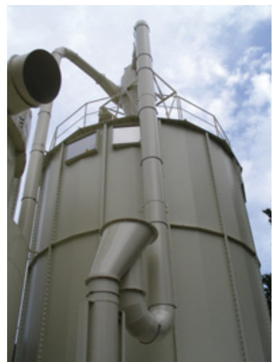
Un silo permet le stockage des copeaux de bois utilisés comme combustible. Il est muni d'évents et d'un dispositif de découplage en cas d'explosion.
