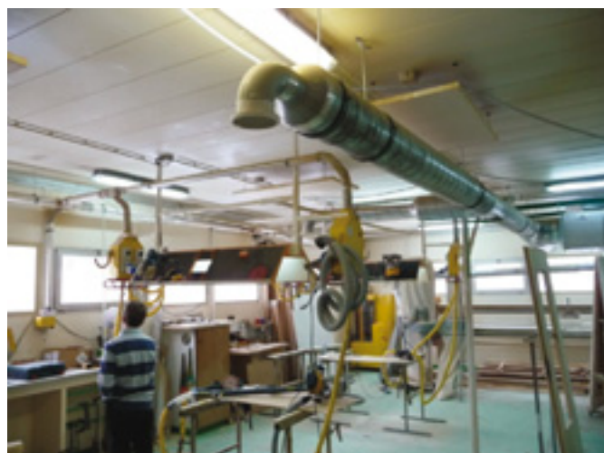
Deux bouches d'aspiration et deux bouches de soufflage au plafond.
