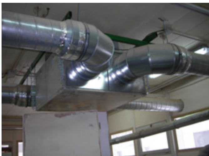
Echangeur de chaleur.
