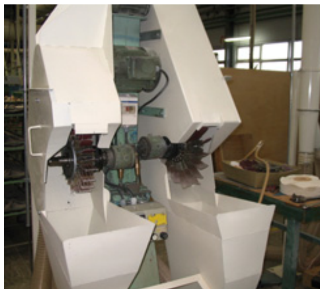
PONCEUSE (APRÈS) Un captage enveloppant largement les zones d'émission et d'éjection des poussières, une prise en compte d'une place suffisante pour les pièces et une augmentation du débit (3 900 m 3 /h) ont permis une diminution considérable de l'empoussièrément (0,6 mg/m 3 ).
