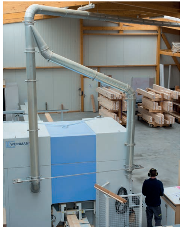
■ Centre d'usinage relié à un réseau d'aspiration
