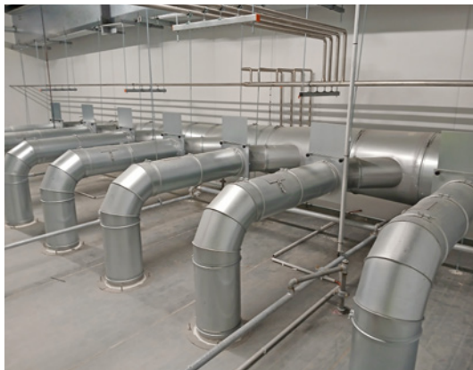
■ Figure 4. Exemple de conduits avec trappe de visite et accès sécurisé.
