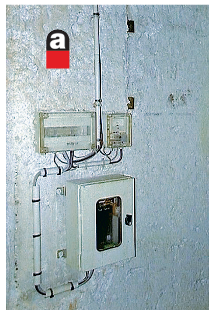
Dans le plâtre amianté ▶
