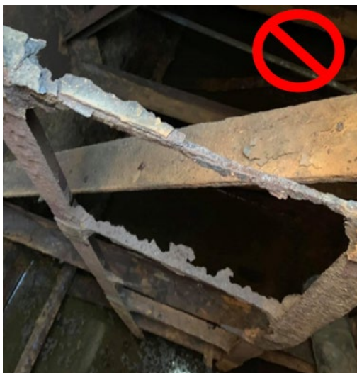
Ejemplo de escalera de acceso dañada.
