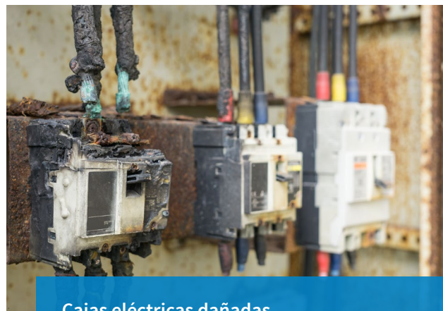
Cajas eléctricas dañadas.
